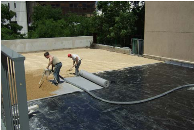
Réalisation d'une couche drainante en gravillons, désolidarisant le sol en béton de l'étanchéité
